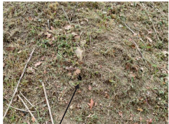
Foto 36: vereinzelte Erdlöcher Böschung
