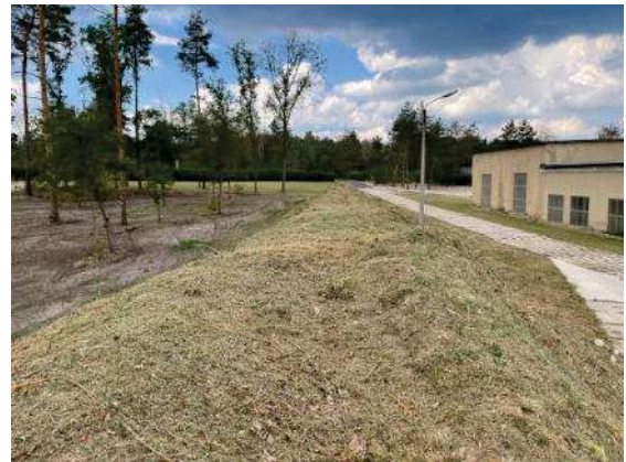
Foto 34: Erdhaufen, kurz gemäht (Blick von der Dammkrone aus)
